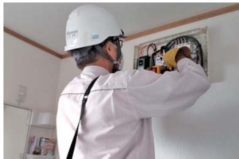
電気の点検 (財)関東電気保安協会日立事業所
